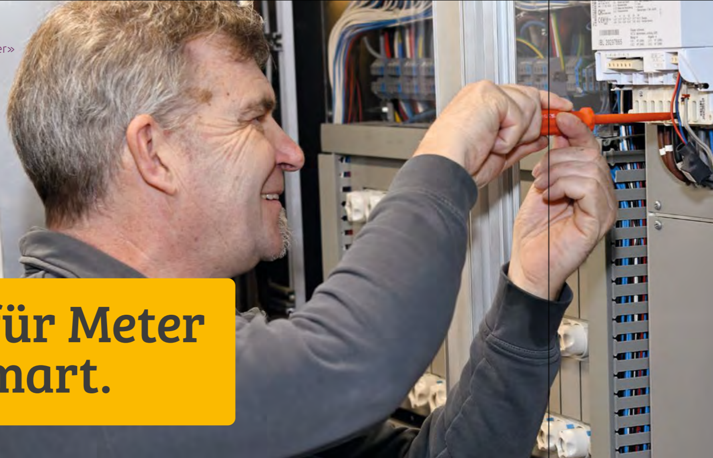
Zählermonteur Josef Lustenberger (Bild links) mit «smartem» Lachen: Die konventionellen Stromzähler werden nach der Demontage fachgerecht entsorgt.
